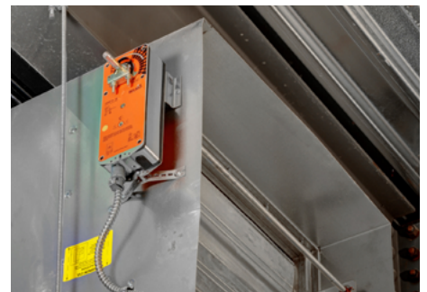
Servomoteurs de registres coupe-feu
